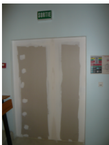
Scurriler „Notausgang“, bezeichnet, aber vermauert!
